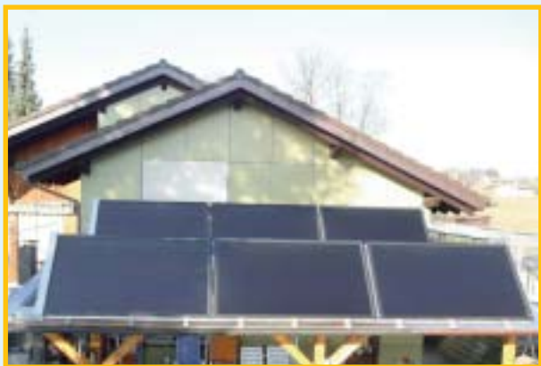
Solaranlage EFH Alpsteinring 19, Arnegg (Bild RS Gebäudetechnik)
